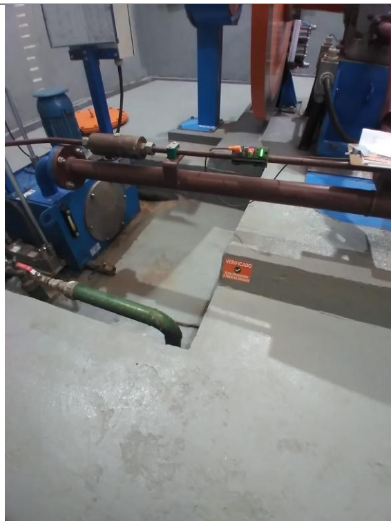
Figura 14: Tubulações e equipamentos da casa de força com registro de verificação.
