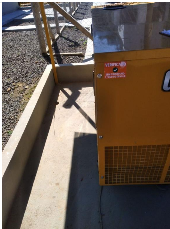
Figura 7: Gerador e base de apoio inspecionados, com identificação de verificação.
