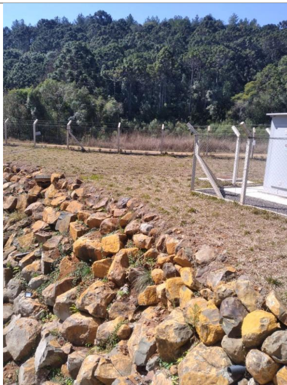
Figura 10: Entorno externo, talude e área vegetada avaliados durante a inspeção.
