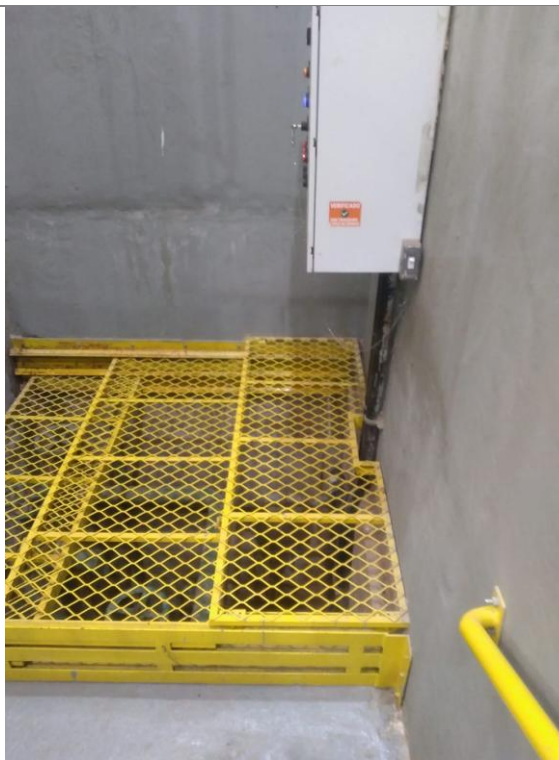
Figura 11: Acesso técnico, plataforma e painel elétrico verificados.
