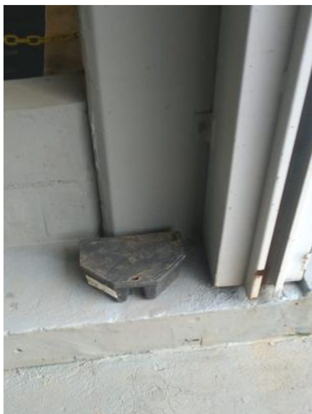
Veneno contra roedores instalado.
