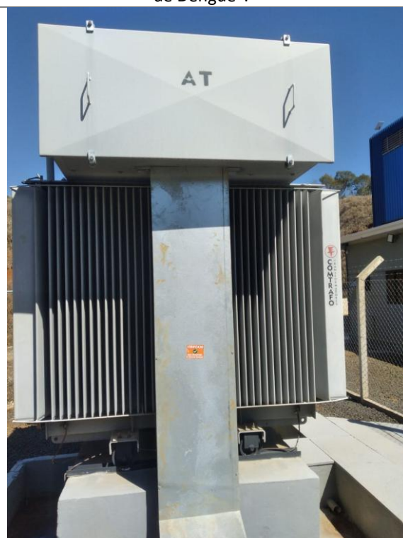
Figura 8: Transformador e área cercada avaliados quanto ao acúmulo de água e presença de criadouros.
