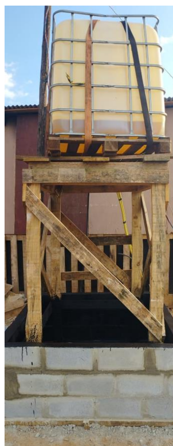
Bacia de contenção do IBC que armazena combustível usado no gerador
