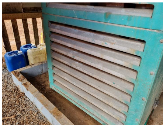
Bacia de contenção ao redor do gerador
