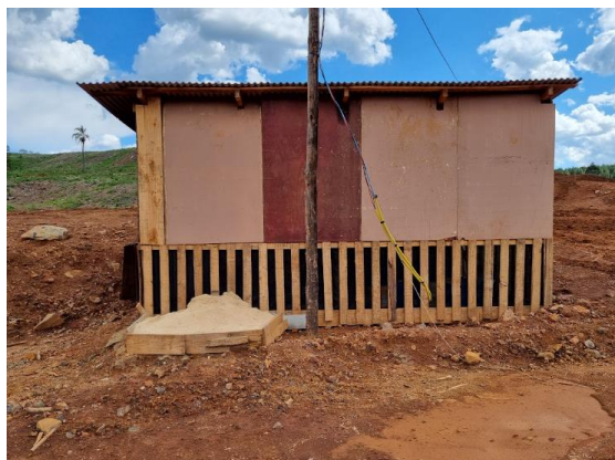
Construção onde fica locado o gerador
